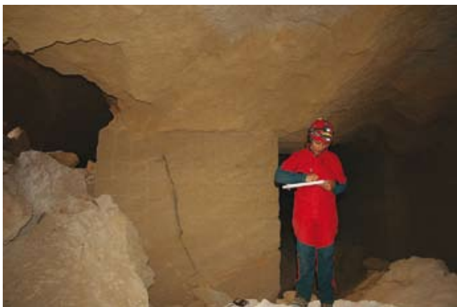
Fig. 5 - Rilievo dei sistemi di fratture e dei crolli nella cava sotterranea.
